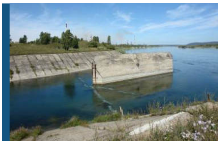
Водозабор АО «АЭХК»
