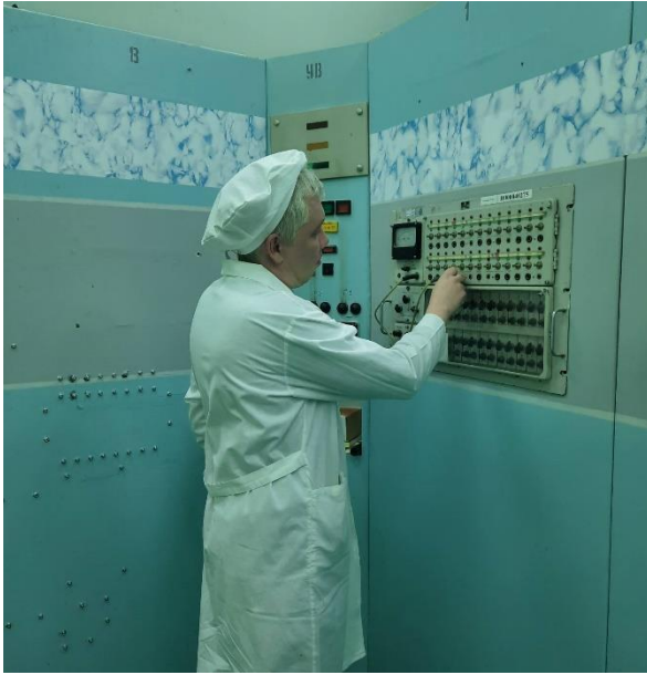
Центральный дозиметрический пульт системы радиационного контроля
