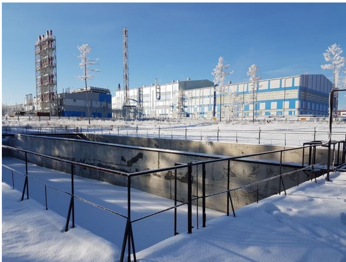
Фото 14. Очистные сооружения ливневых и талых вод
