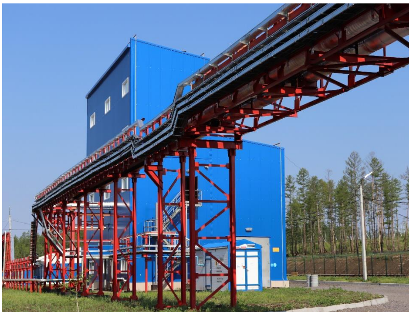
Фото 3. ЛСУ месторождения Источное
