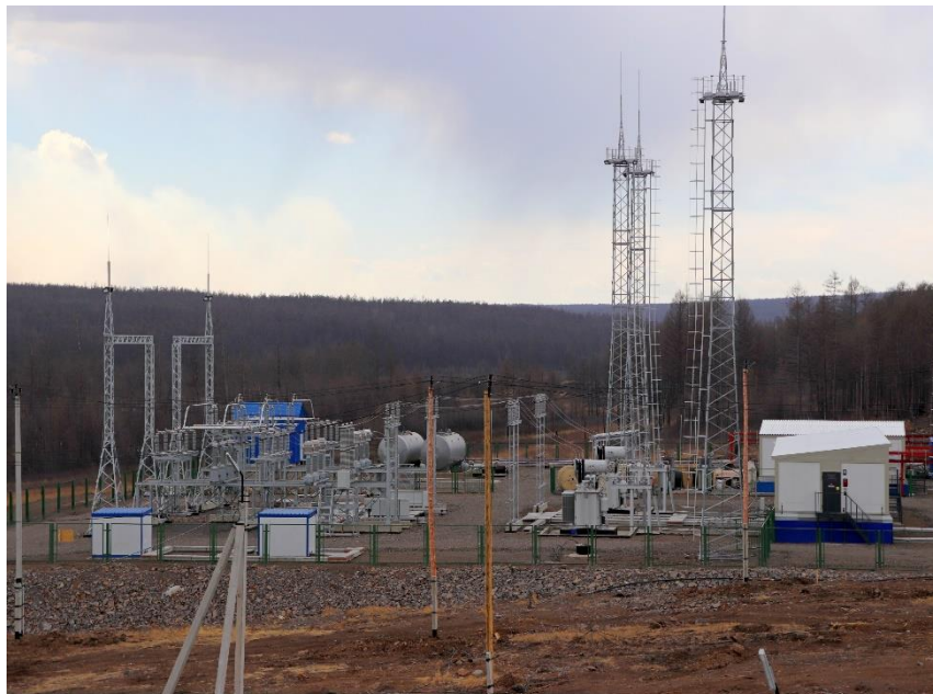
Фото 4. Подстанция «Джилинда» 110/10 кВ
