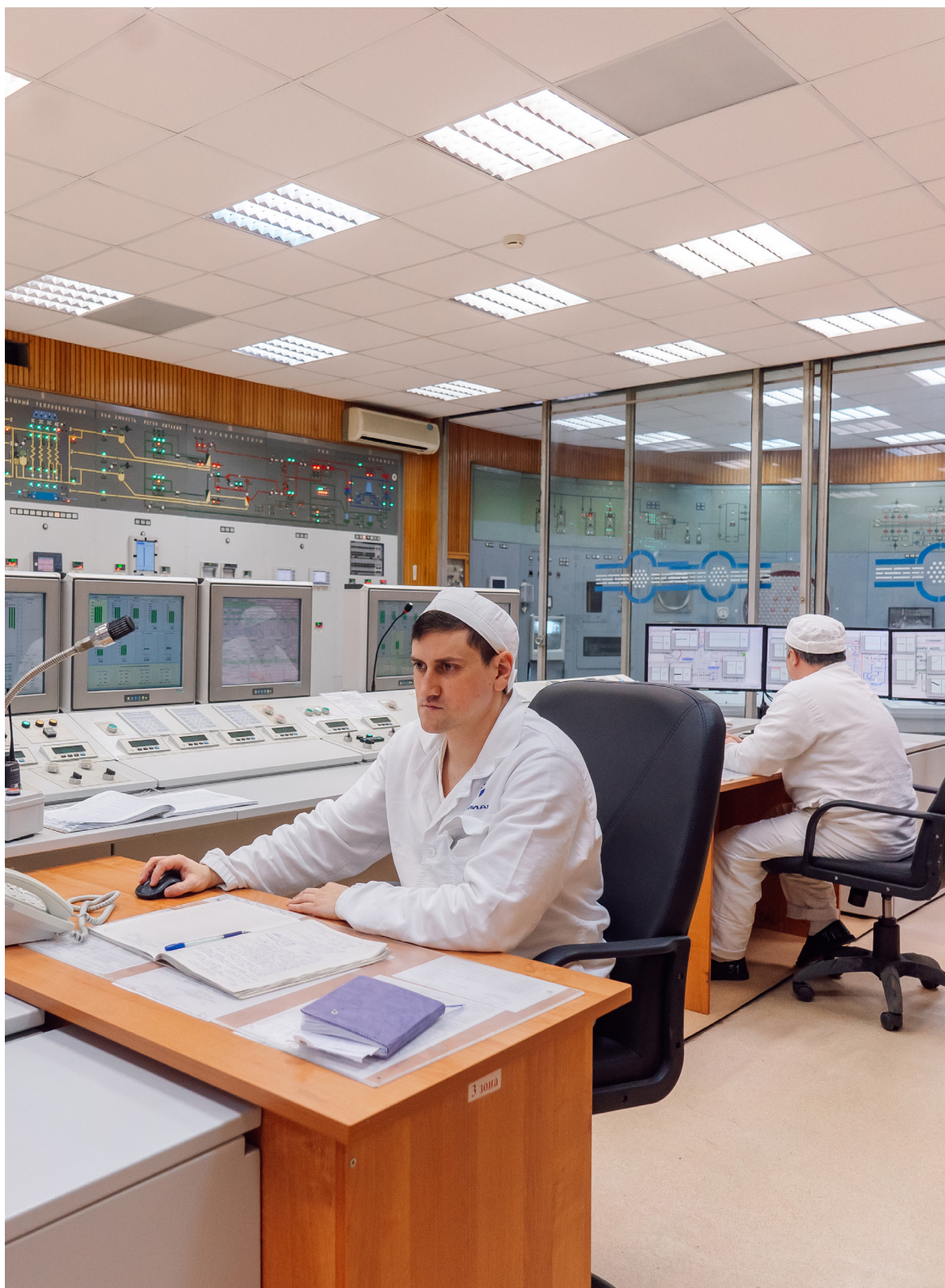
▲ Пульт управления реакторной установки БОР-60
