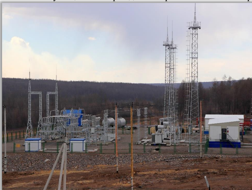
Фото 4. Подстанция «Джилинда» 110/10 Кв
